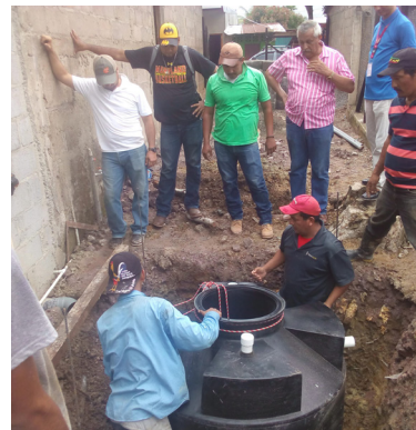
Prácticas de instalación del sistema biodigestor autolimpiable en Escuela de Oficio de San Rafael del Norte , Jinotega.
